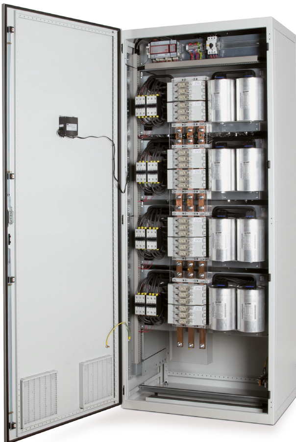
Bild 9: Blindleistungkompensationsanlage im Standschrank
